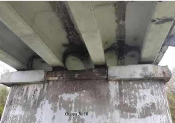
Дефекты балок пролетных строений и опор пролет №10 над опорой №10
