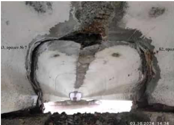
Дефекты балок пролетных строений и опор между балками Б2-Б3 над опорой №8
