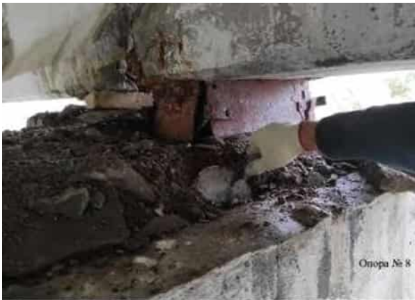
Размораживание бетона с оголением и коррозией арматуры на опоре №8
