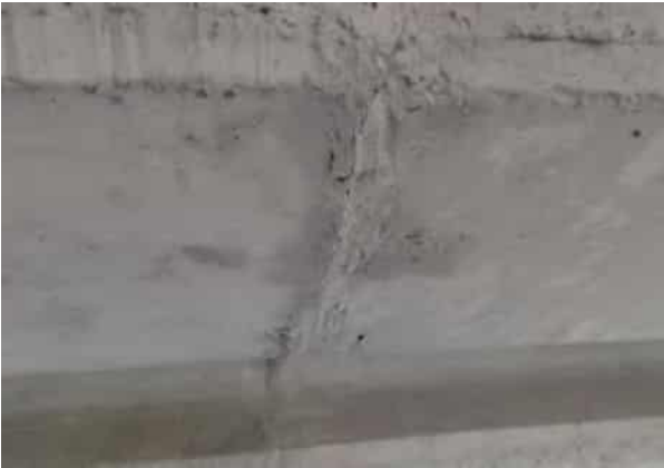
Вертикальные силовые трещины по стыку №2 балки Б3 в пролете №7
